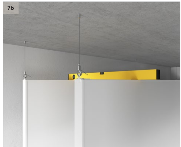
Richten Sie die Baffeln mit Hilfe einer Wasserwaage aus. Die verstellbaren Drahtseilhalter ermöglichen eine problemlose Justierung in der Höhe.
